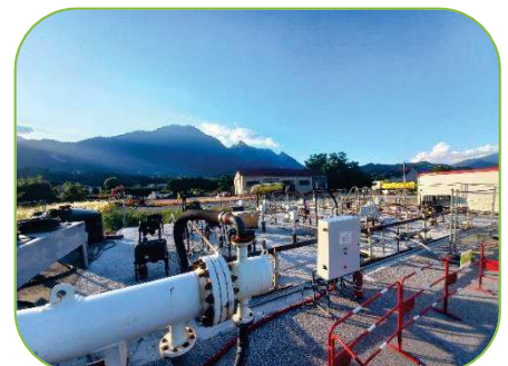
Installation de traitement
